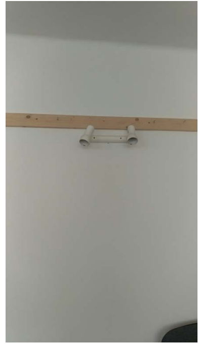
Oldalfalra szerelt megvilágítás
