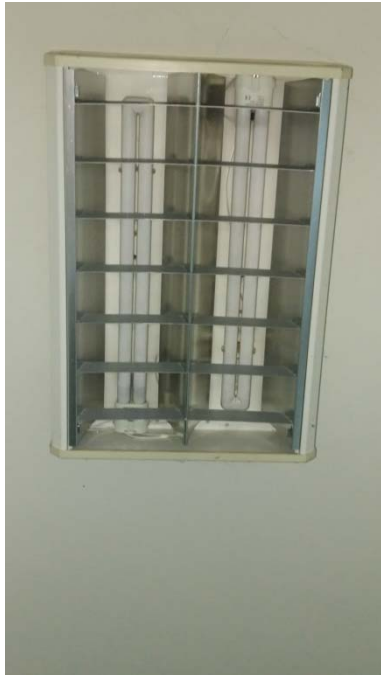
Fénycsöves mennyezeti világítás
